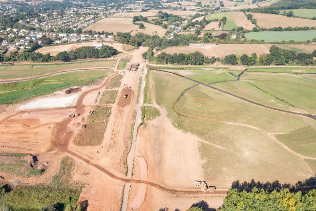
Photo 2.17 La nouvelle route de South Farm en cours de construction (Source : KOR)
